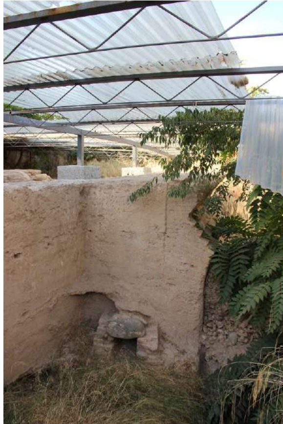
Restos de la Puerta Innominada y de la acequia que podrían corresponder a la acequia de Aynadamar y estructura de protección deteriorada sobre ellos
